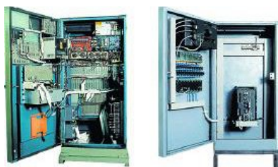
Umrüstung von Siemens S5 auf S7
